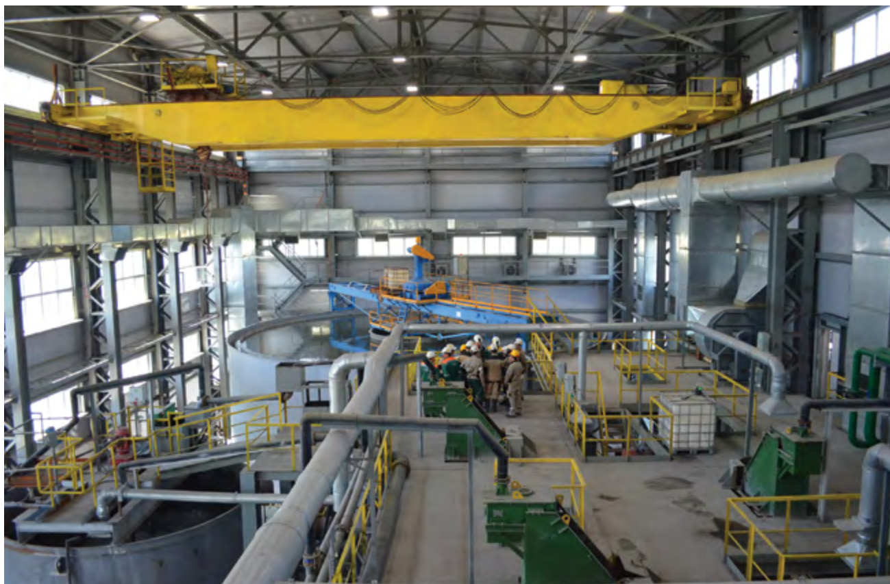
Цех горячего выщелачивания рудника Суздаль
