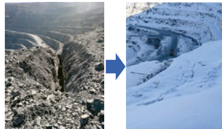
Пример развития деформационных процессов на юго-западном борту карьера (берма на гор. -35 м с 08.2023 по 02.2025)
